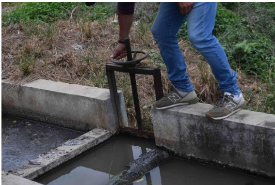
Llave en mal estado. Planta de Sabanilla Fuente: Visita de campo. A-Hualpa. Abril, 2024
