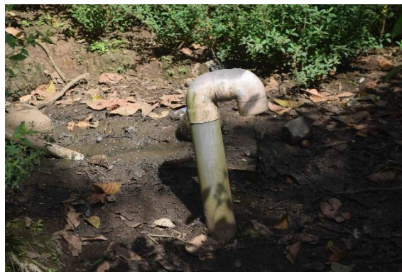
Pozo de aguas servidas colapsado de Cruzpamba Fuente: Visita de campo. A-Hualpa. Abril, 2024
