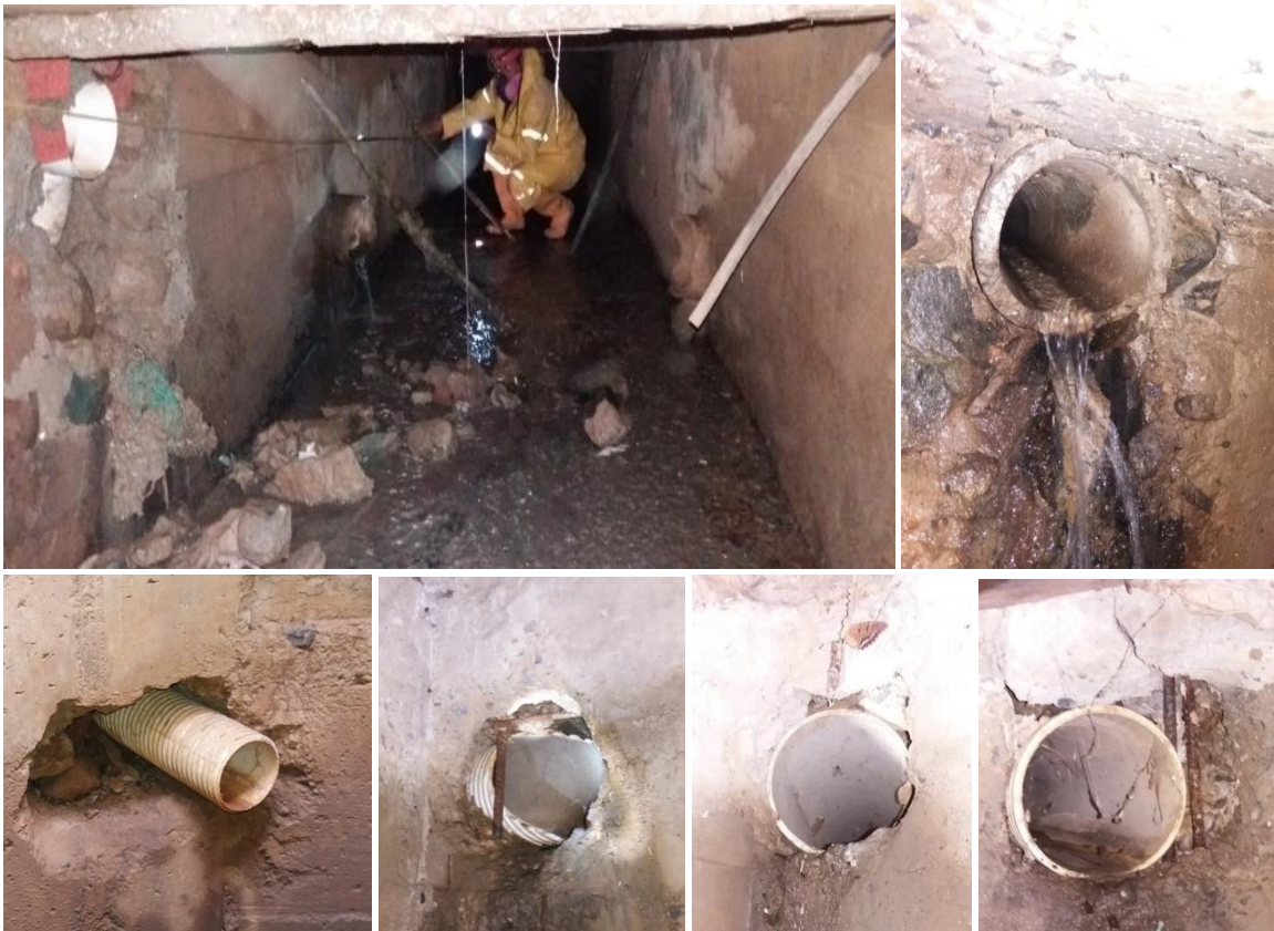
Imagen 7: Documentación fotográfica de las conexiones clandestinas que deterioran el embaulado de la ciudad de Celica
