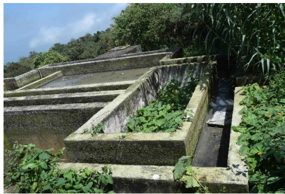
Planta de tratamiento de aguas servidas de Pózul Fuente: Visita de campo. A-Hualpa. Abril, 2024
