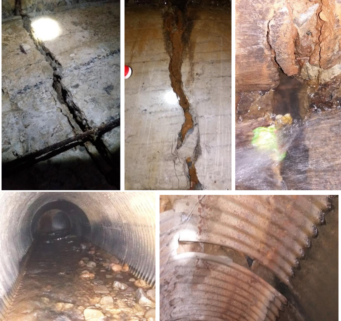
Imagen 6: Documentación fotográfica del deterioro de los costados del embaulado de la ciudad de Celica
