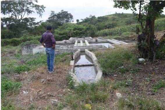
Planta de tratamiento de aguas servidas de Sabanilla Fuente: Visita de campo. A-Hualpa. Abril, 2024
