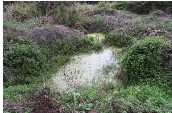
Filtración de aguas servidas. Planta de Sabanilla Fuente: Visita de campo. A-Hualpa. Abril, 2024
