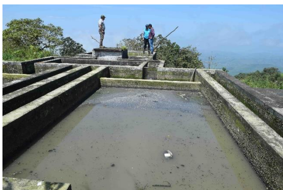
Planta tratamientos aguas servidas de Pózul. Fuente: Visita de campo. A-Hualpa. Abril, 2024
